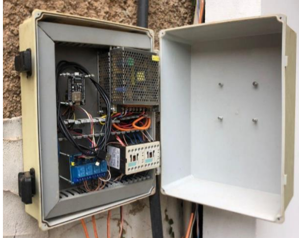
Figura 6: Quadro de comandos
